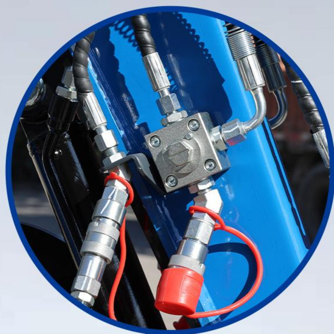
Quatre canalisations + vanne à soupape
